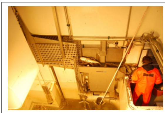
Bilde 18 Bløggestasjon ved dragerbrønn
